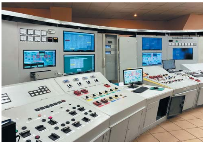
Рис. 1. Помещение щита управления КТЦ Уфимской ТЭЦ-2
