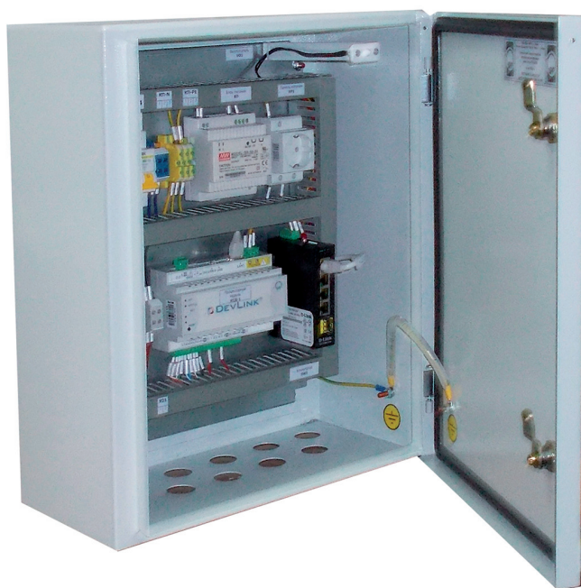
Рис. 2. Шкаф сбора данных с приборов учета энергоресурсов
