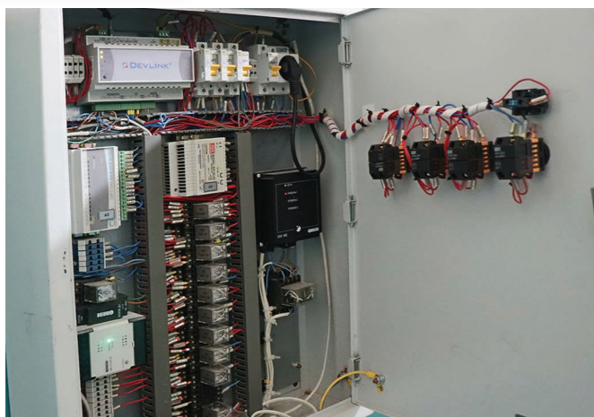
Рис. 3. Контроллер DevLink-C1000 в шкафу управления котельной
