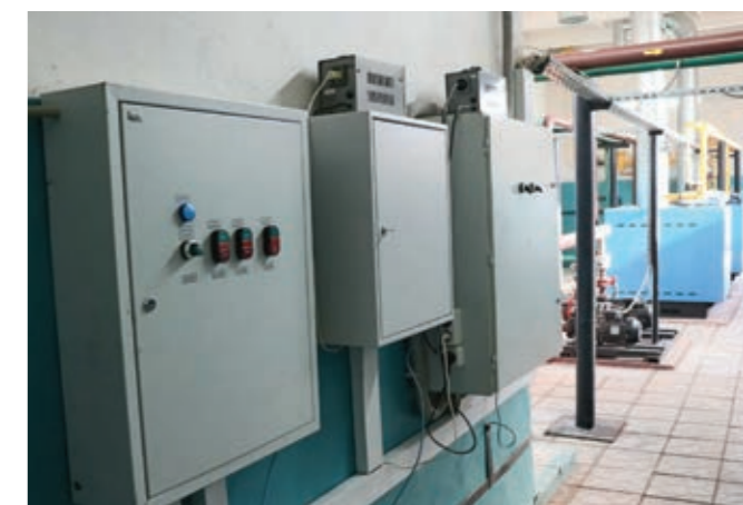
Рис. 2. Шкафы автоматики в помещении котельной
