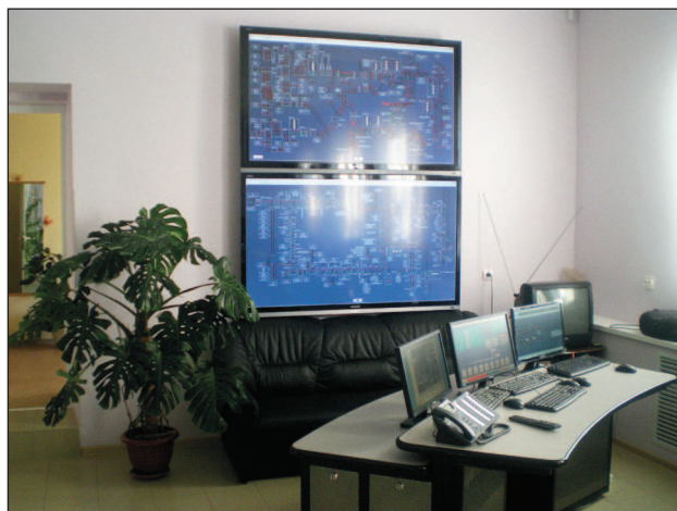
Рисунок. Центральный диспетчерский пункт ОАО «СаранскТеплоТранс».
